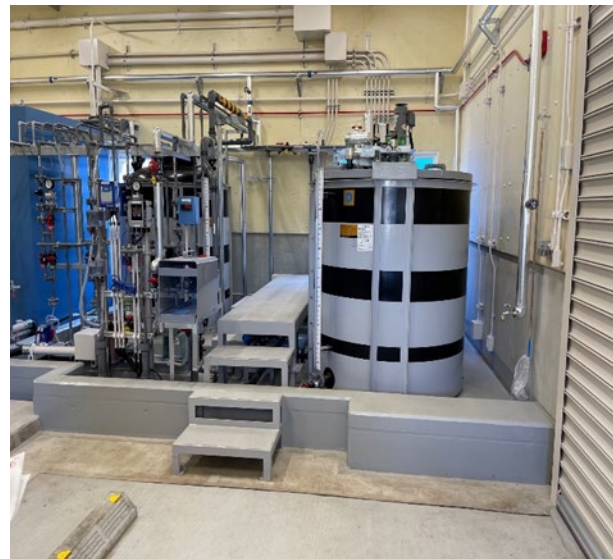
図 2 次亜塩素酸とフッ素貯蔵タンク
